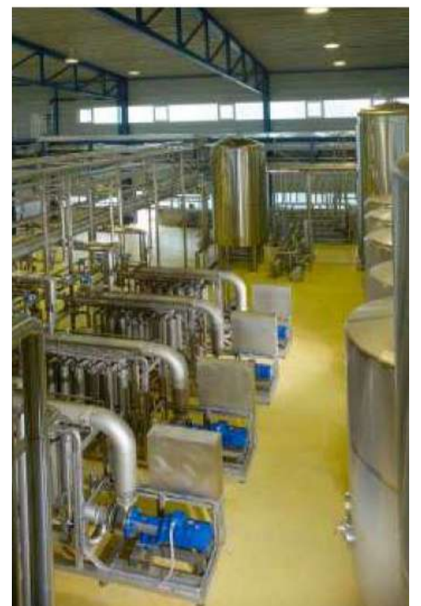
Installation de filtration membranaire Heineken
